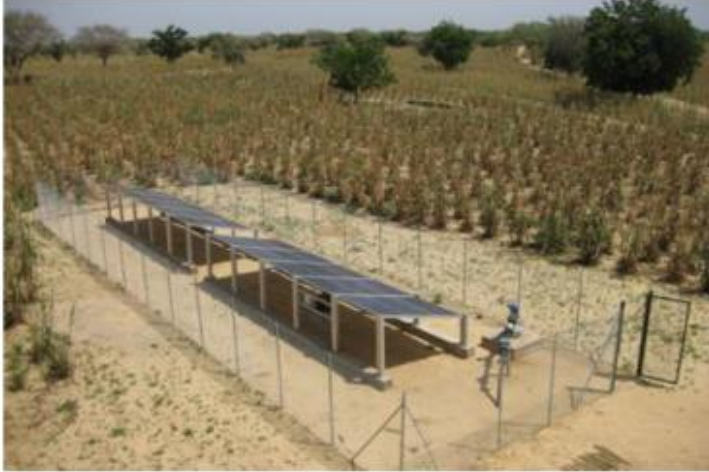
Champ de panneaux solaires clôturé
