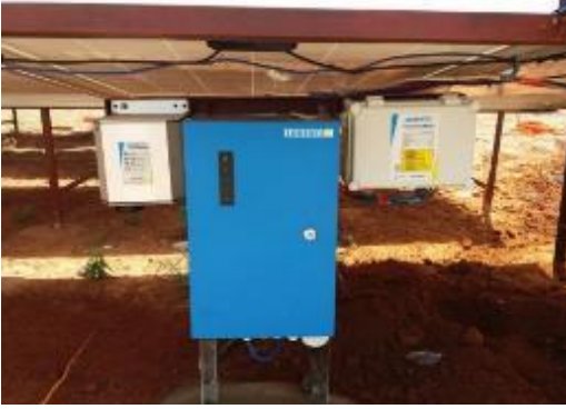
Présentation d'un contrôleur de pompe d'une station de pompage d'eau solaire
