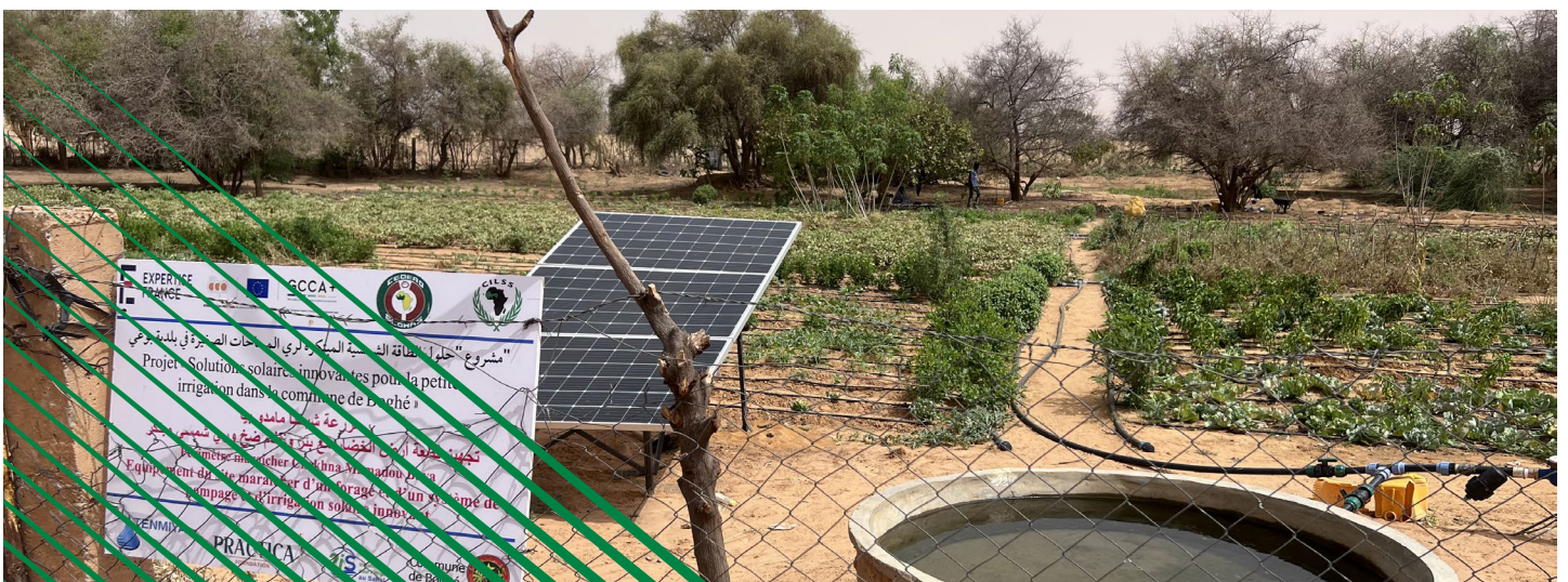
Figure 1: Système d'irrigation au champ et système de pompage solaire.
